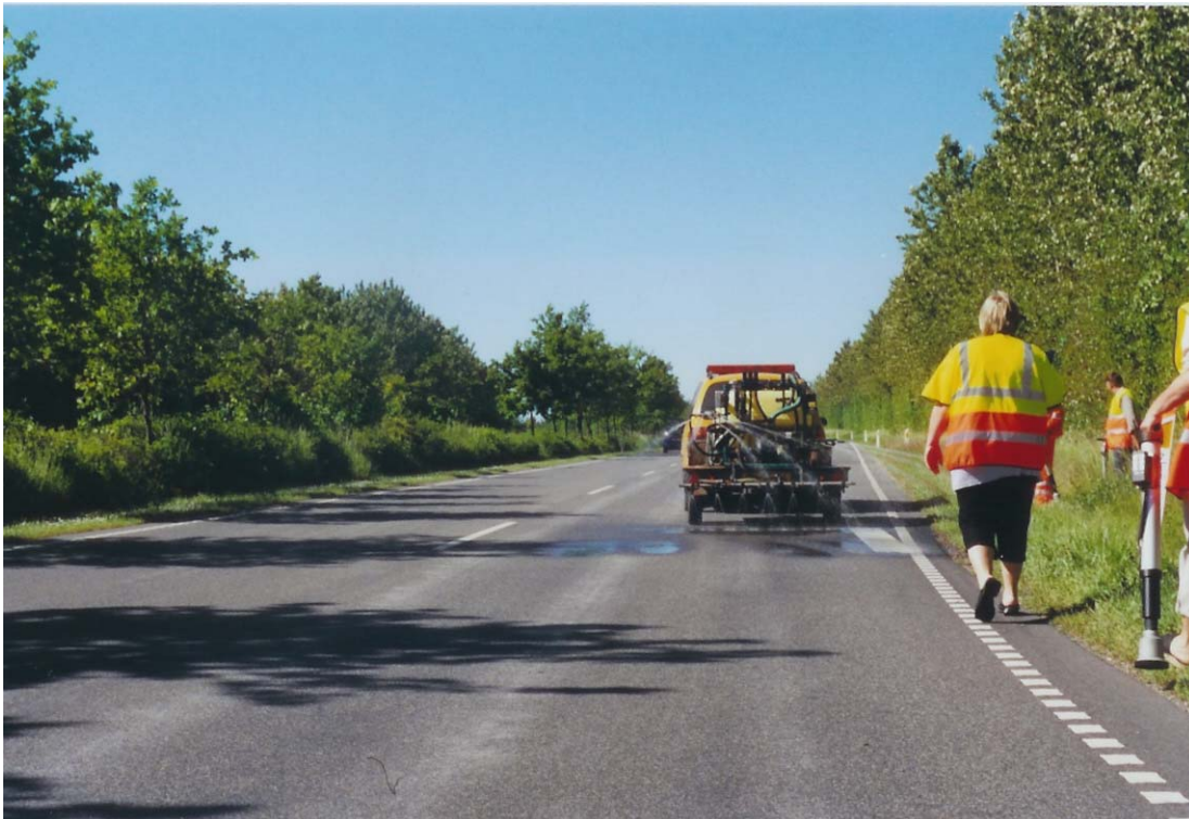
Ldv 509 km 5,0700 – 5,0900 (Vandspreder konstrueret af eget værksted)
